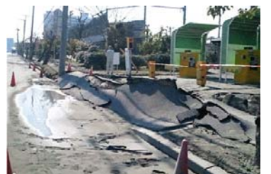
（今回の地震で液状化現象により、隆起した浦安市運動公園）
