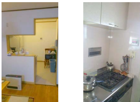
キッチンを壁側から対面式に変更し、耐力壁を追加しました。
