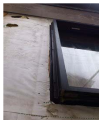
①雨漏りの原因となる2階の窓、窓脇の防水処理はされていませんでした。
