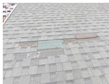
台風による屋根材の欠落
