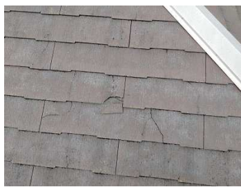
屋根材の割れ・ヒビ
