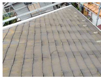
屋根材の色褪せ
