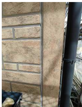
コーキングの劣化
